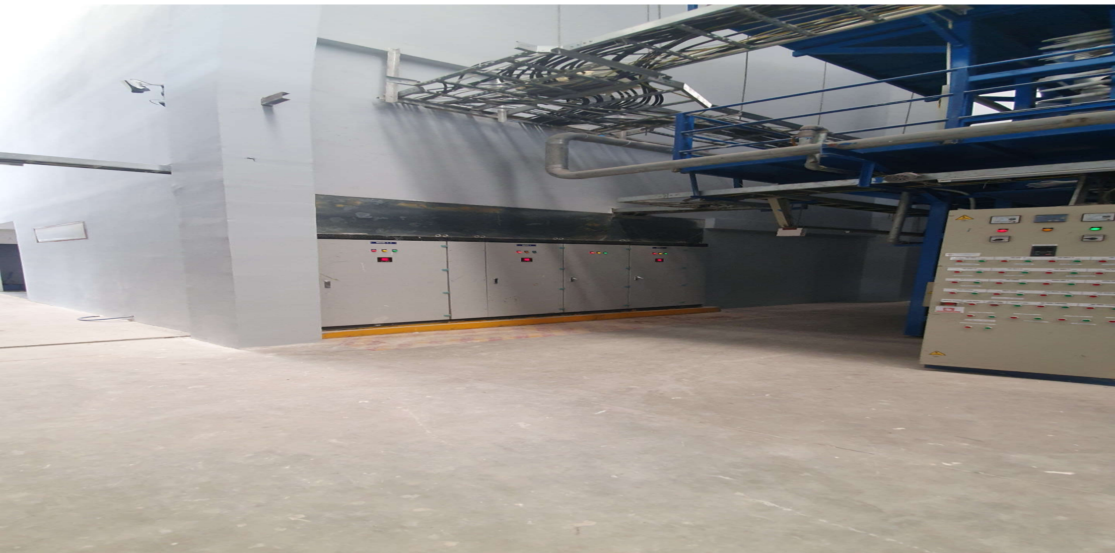
Hệ thống điện cung cấp phục vụ sản xuất
